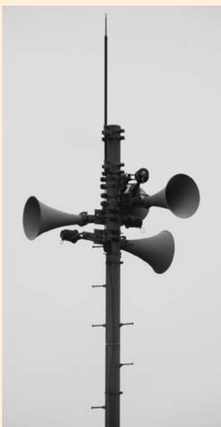
町内全域で統一される防災行政無線設備
